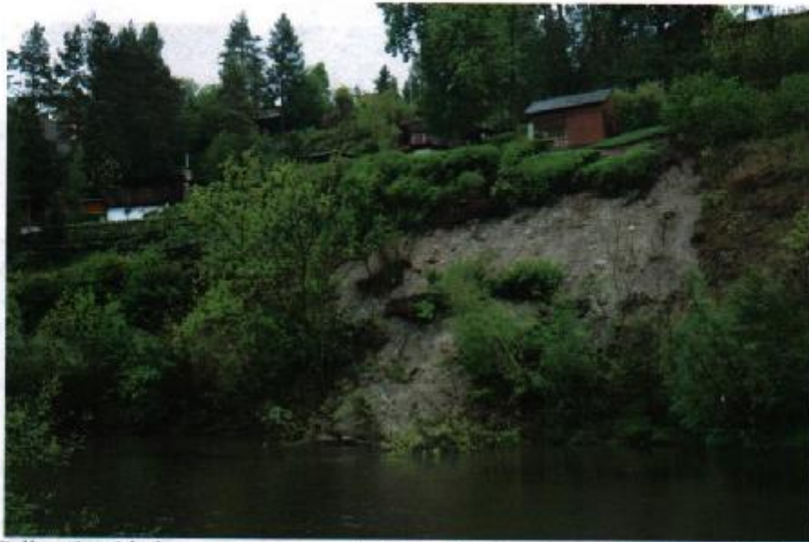
Obr. 5.: Celkový pohled na sesuvné území k.č. 507/1 v Levousech (Foto O. Krejčí, květen 2011).
