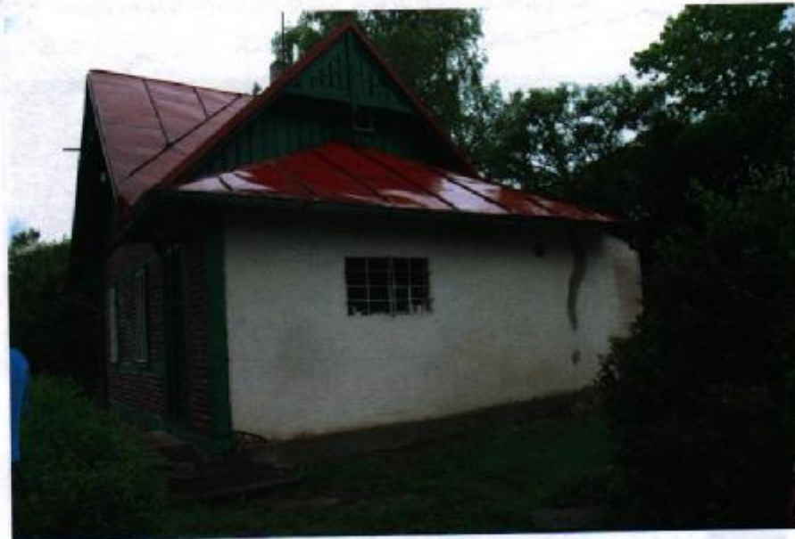
Obr. 7. Pohled na poškozený dům v odlučné oblasti sesuvného území u silnice na Stradonice. Foto O. Krejčí, květen 2011.
